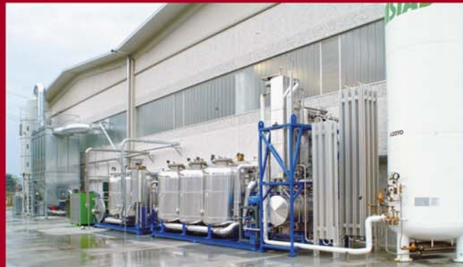
▲ Impianto di condensazione CFC con carboni attivi e torre criogenica
