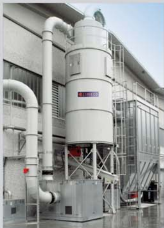
▶ Impianto di depolverizzazione di plastica, rame e alluminio
