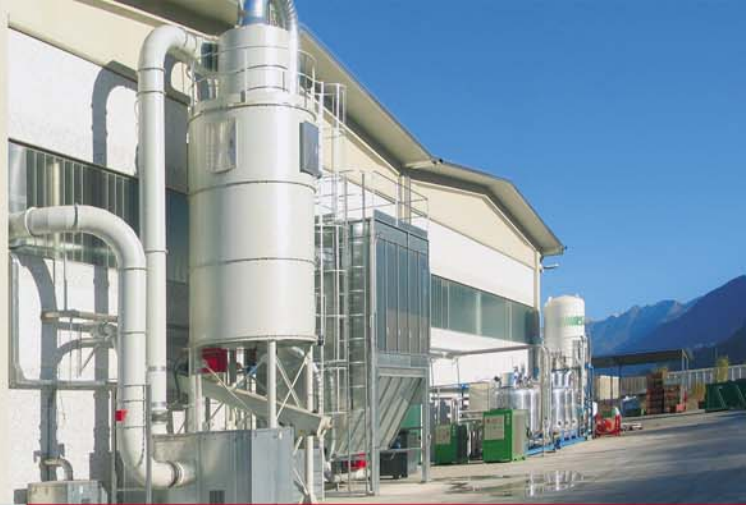
▲ Impianto di recupero del poliuretano e filtrazione dell'aria
